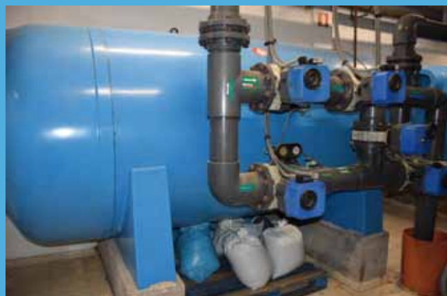
Figura 6. Equipo de filtración de la piscina grande del Complejo Deportivo La Magdalena.
